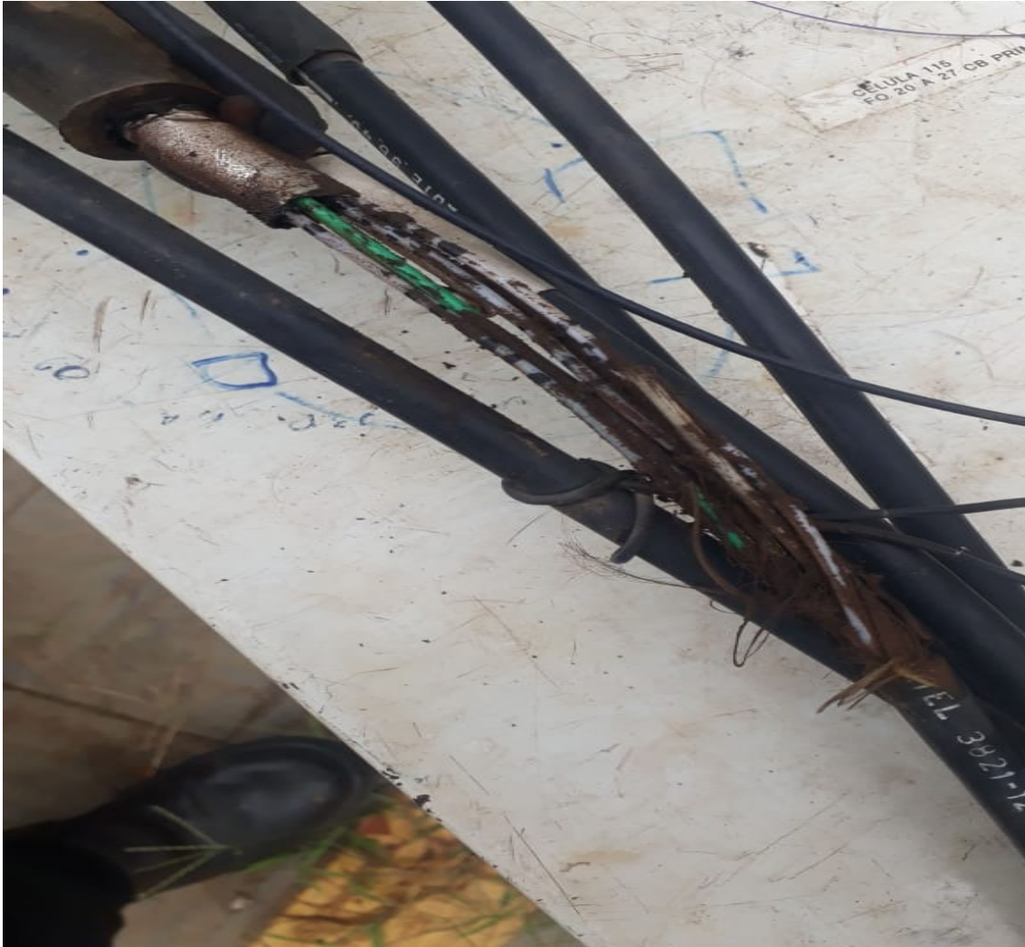
Imagem 02 - 03.04 – Rompimento de Fibra – Vandalismo – Chamado 2020040579
