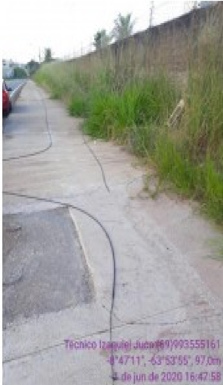
Imagem 04 - 01.06 – Rompimento de Fibra – Descarga Elétrica – Chamado 2020060158
