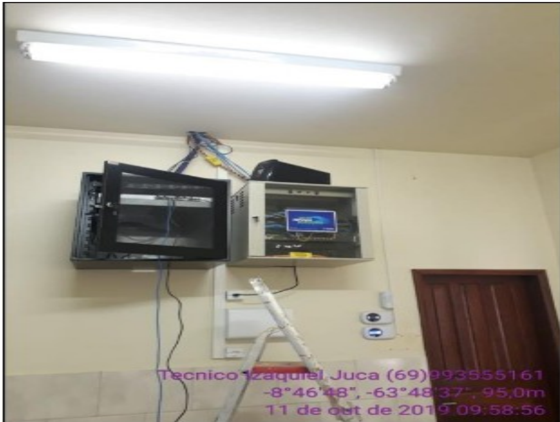
Imagem 04 - 11.10 - Rompimento de fibra - Escavação de trator - Chamado 2019052098
