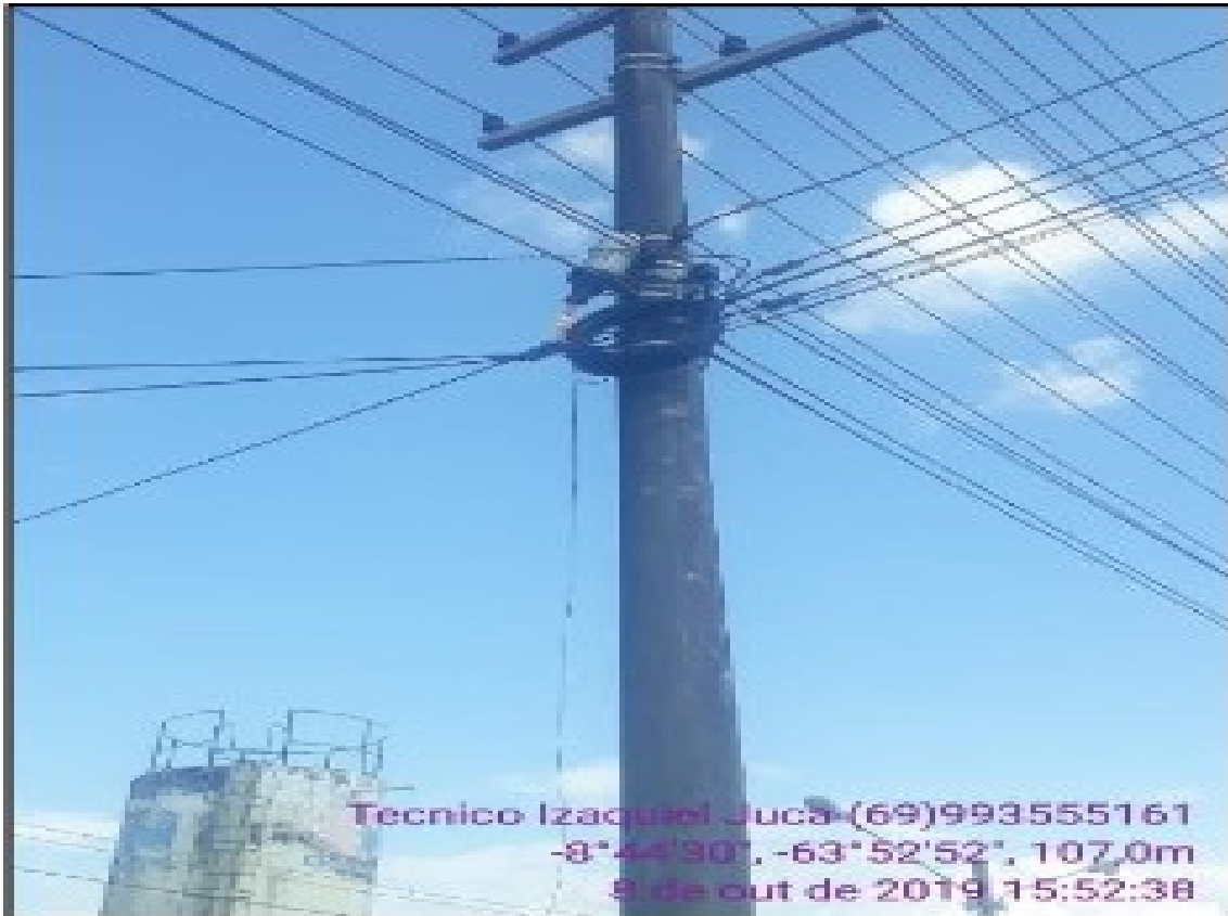
Imagem 03 - 09.10 - Rompimento de fibra - Chamado 2019054653
