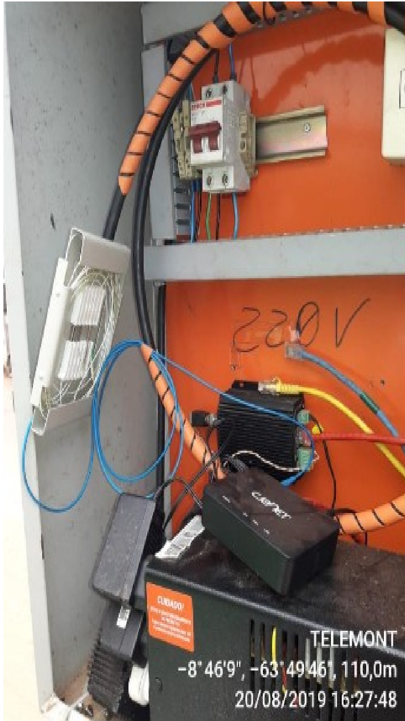
Imagem 05 - 22.10 - Rompimento de fibra - Chamado 2019050920
