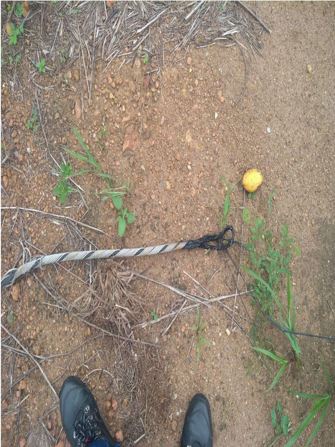
Imagem 08 - 30.12 - Rompimento de Fibra - Chamado 2019058679
