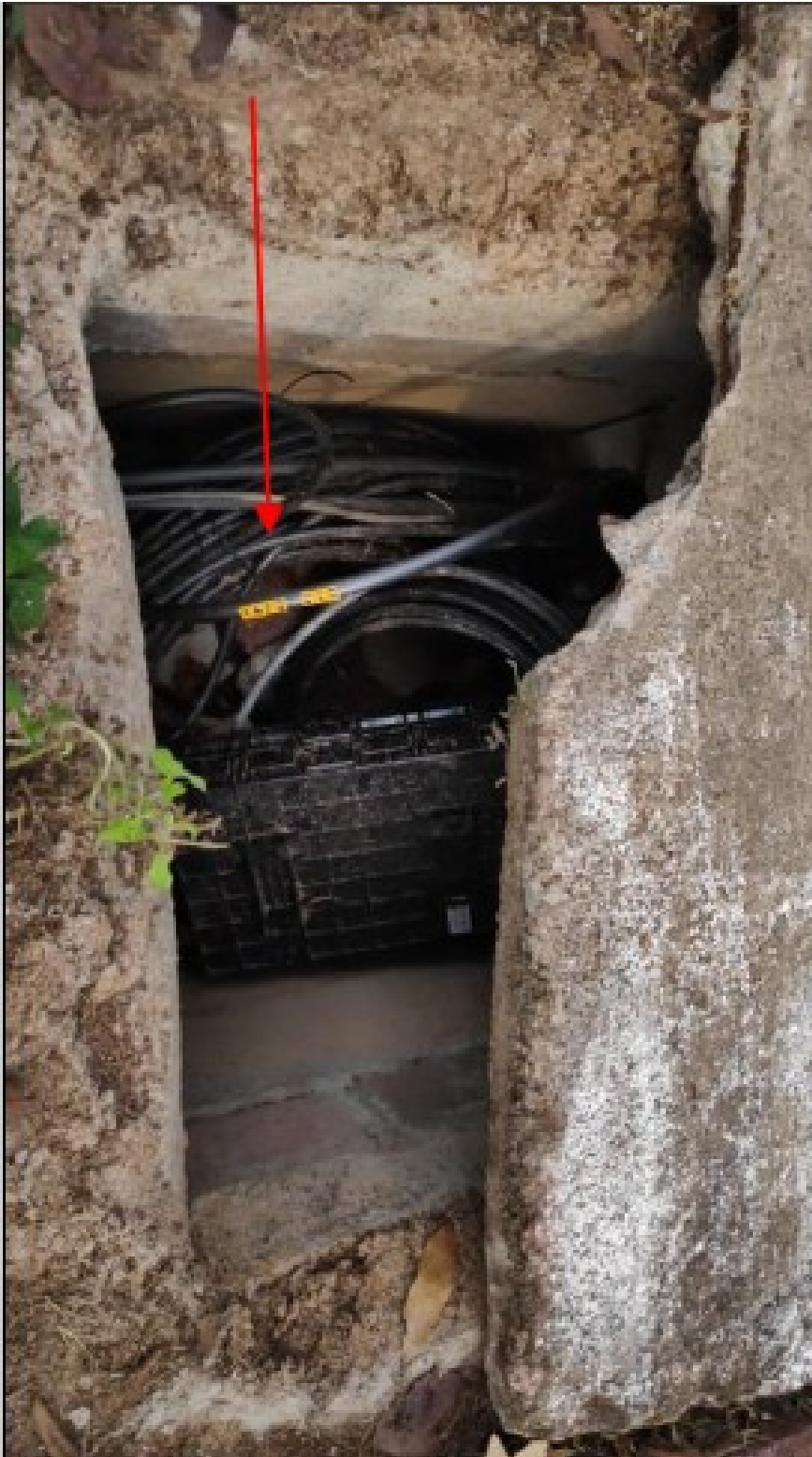
Imagem 06 - 25.10 - Rompimento de Fibra - Manutenção Predial - Chamado 2019052142
